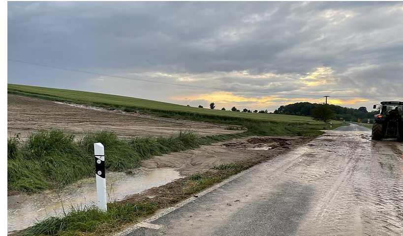
Abschwemmungen von Erdreich
